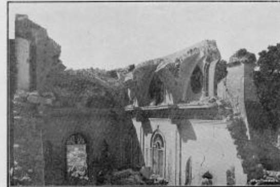
Fig. 32.—Restos de la capilla del Sagrado Corazón, en Acambay, recién construida, junto a la iglesia del mismo pueblo. Conservación de los muros, apalillados N.-S., que sustentan la bóveda, y del muro meridional. A la derecha se ven los restos de la torre.
