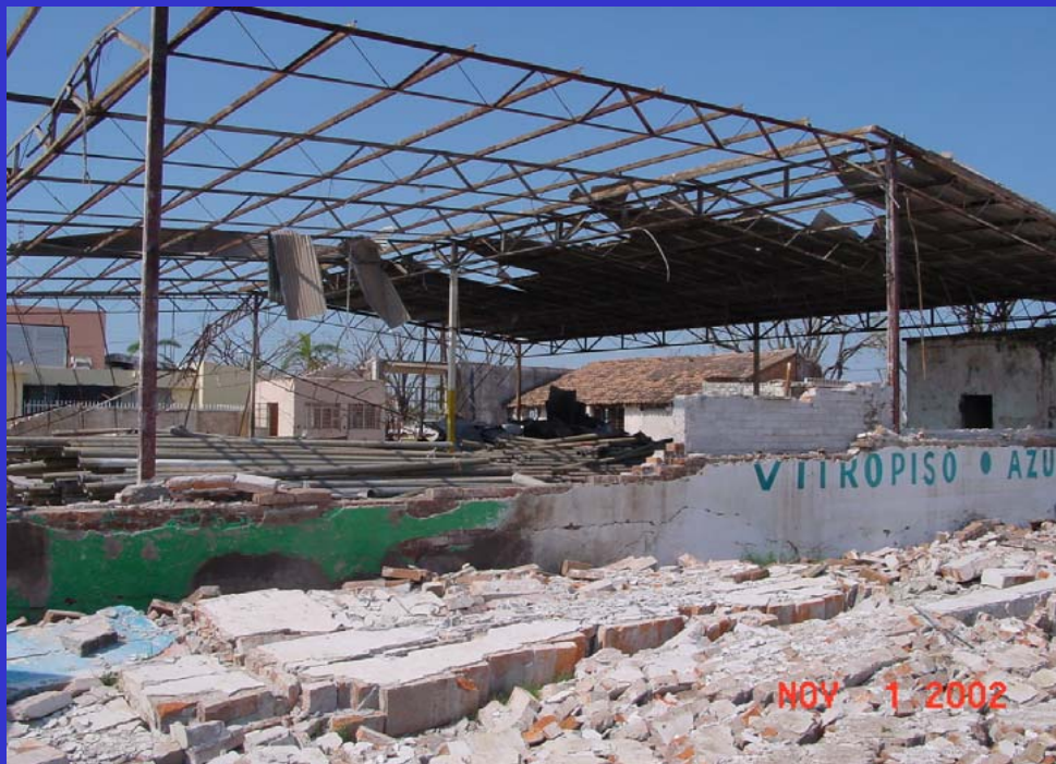
Daño por viento en San Blas, Nayarit.
